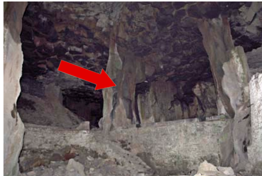
Mittlerer Teil des Bierkellers, hier vom Eingang aus fotografiert. Die nicht mehr stabile Säule ist mit einem roten Pfeil markiert.
