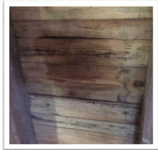
Bild 3: Urindurchnässungen an der Dachverschalung.
