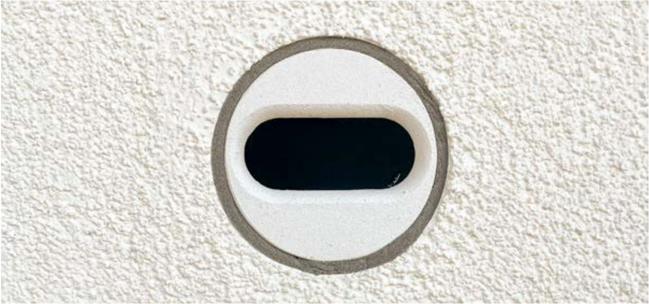
In Wärmedämmverbundsystem (WDVS) eingelassener Nistkasten für Mauersegler
